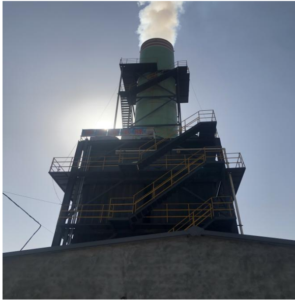
图 3-1 脱硫塔+湿电除尘+38m 排气筒
